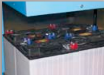
Gruppo batterie 24V. Unit batteries 24V.
